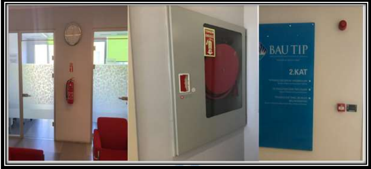
Şekil 75. Göztepe Eğitim ve Araştırma Kampüs Binalarına Yerleştirilmiş Yangın Tüpleri ve Sensörlerinden Örnek Fotoğraflar
